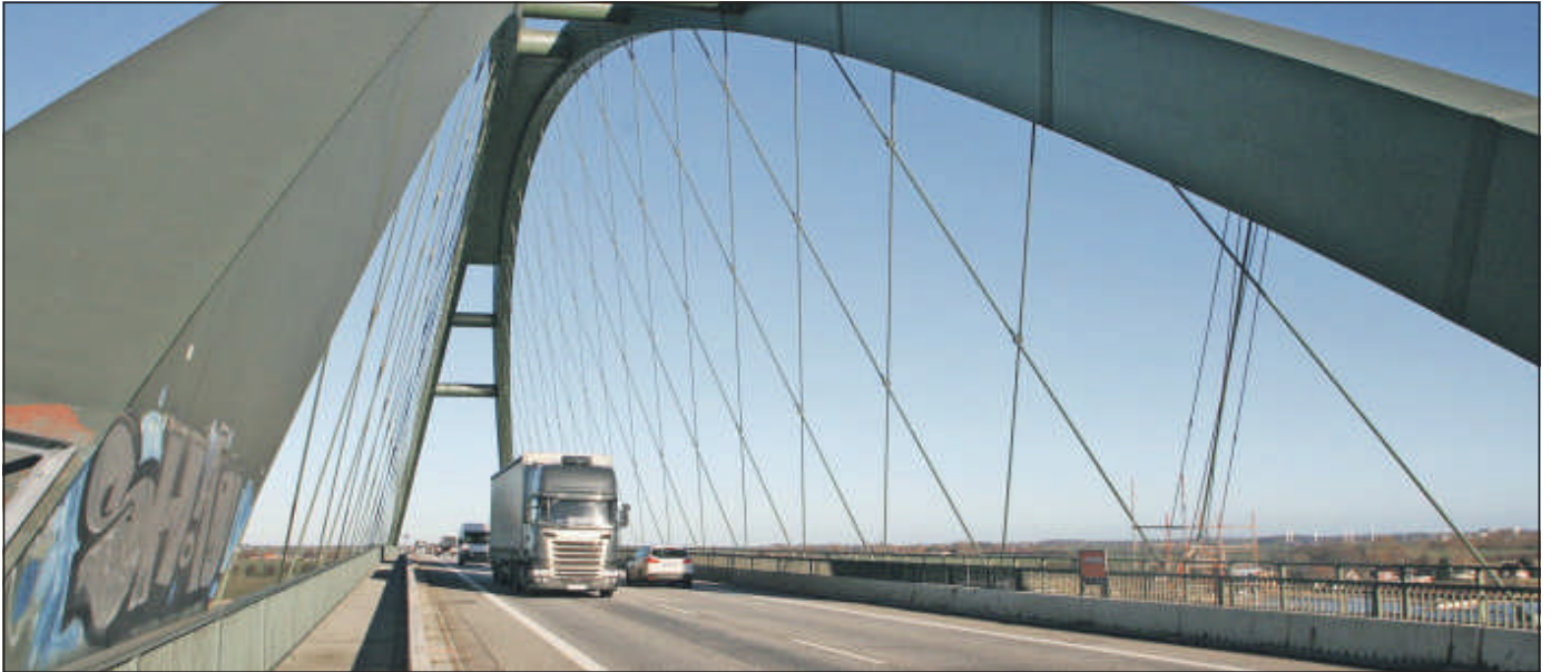
Sorgenkind Fehmarnsundbrücke: Das defekte Tragseil auf der Ostseite will die Deutsche Bahn im Frühjahr ersetzen. ■ Foto: Höppner
